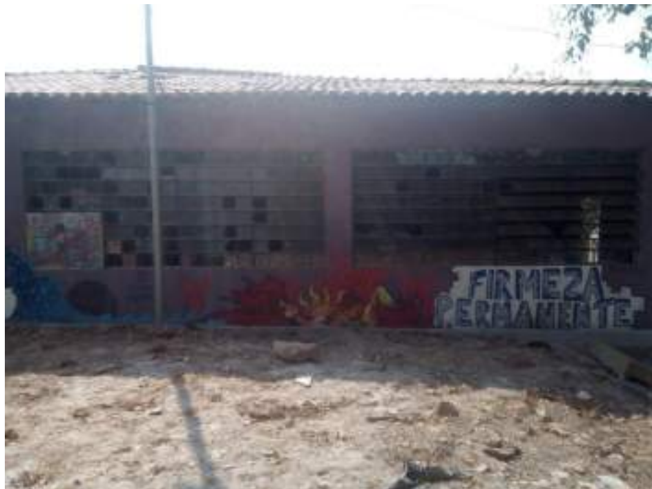
Vidros vandalizados em 24.09.2017
