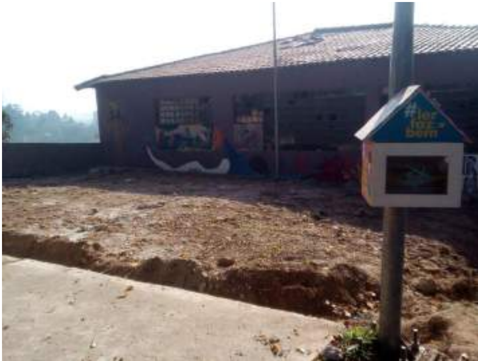
Nivelamento do terreno ao lado do espaço para fins de criação de espaços de convívio e retirada de ponto viciado de descarte de entulho e móveis
